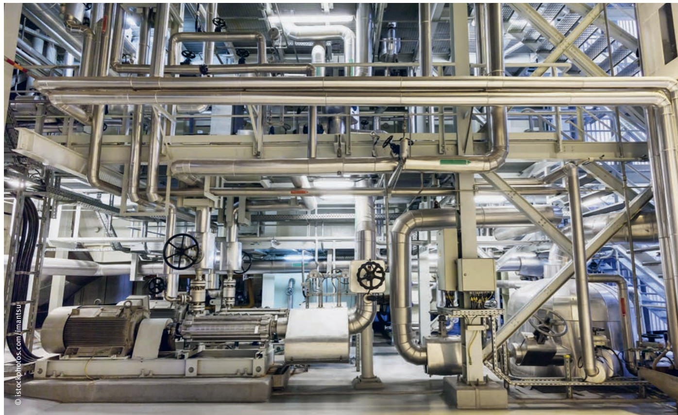
Modernes Blockheizkraftwerk mittlerer Leistung
