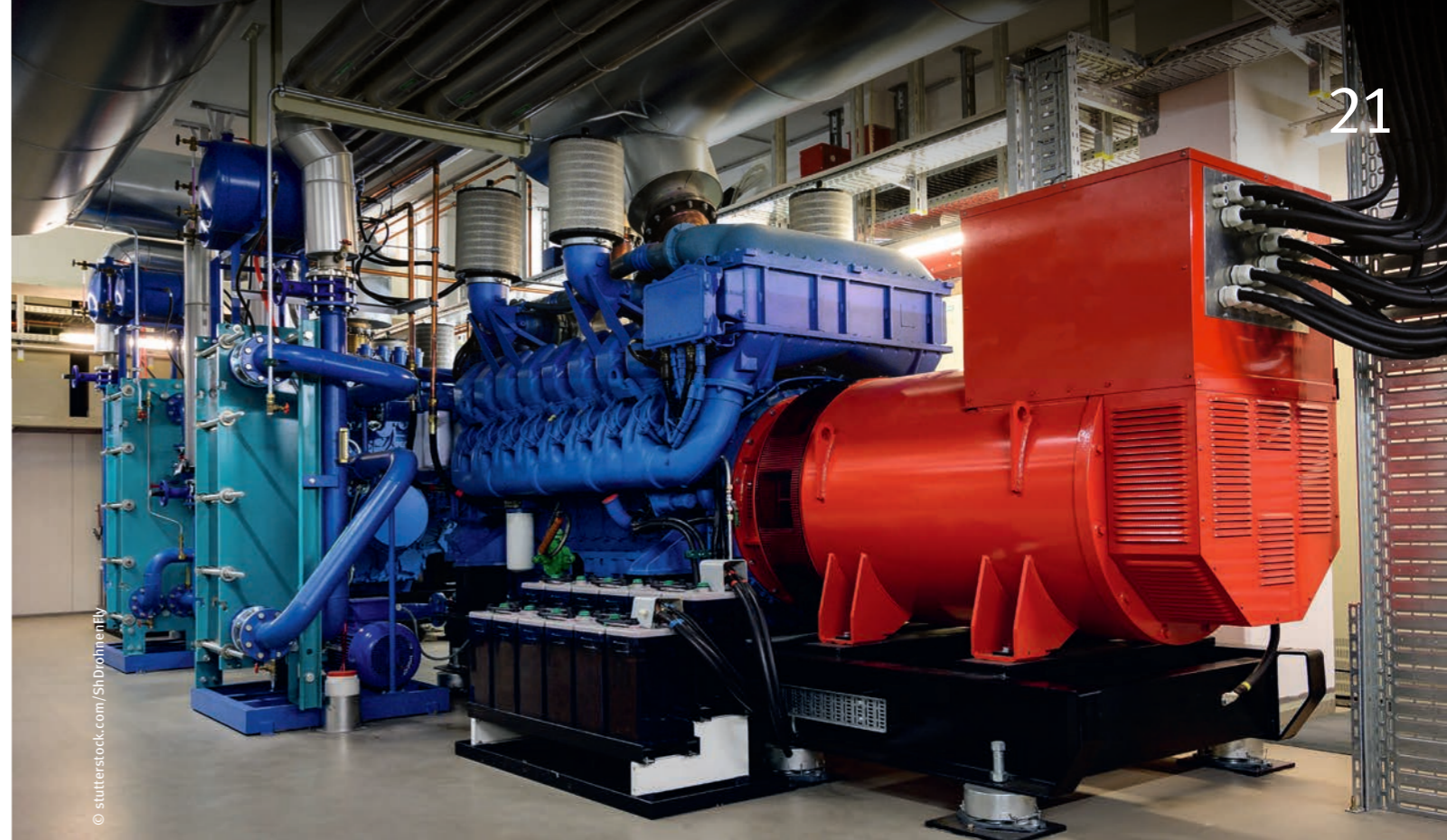
© shutterstock.com/ShDrohnenTV Grosses Diesel-Notstromaggregat für ein Rechenzentrum.
